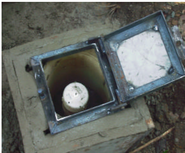
Figura 4. Caixa de concreto usada para proteção dos piezômetros.
