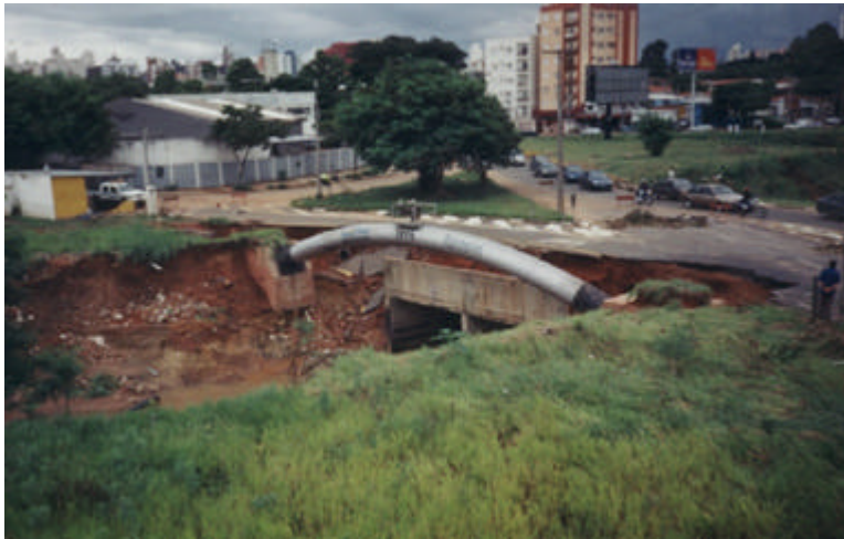
Foto 6. Erosão provocada pela enchente do dia 17/02/2003 no início do ribeirão Anhumas (Via Norte/Sul). Data 18/02/2003.
