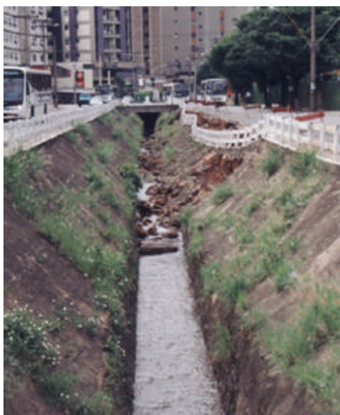
Foto 4. Desmoronamento da margem do canal da av. Anchieta durante a enchente do dia 17/02/2003. Data 18/02/2003.
