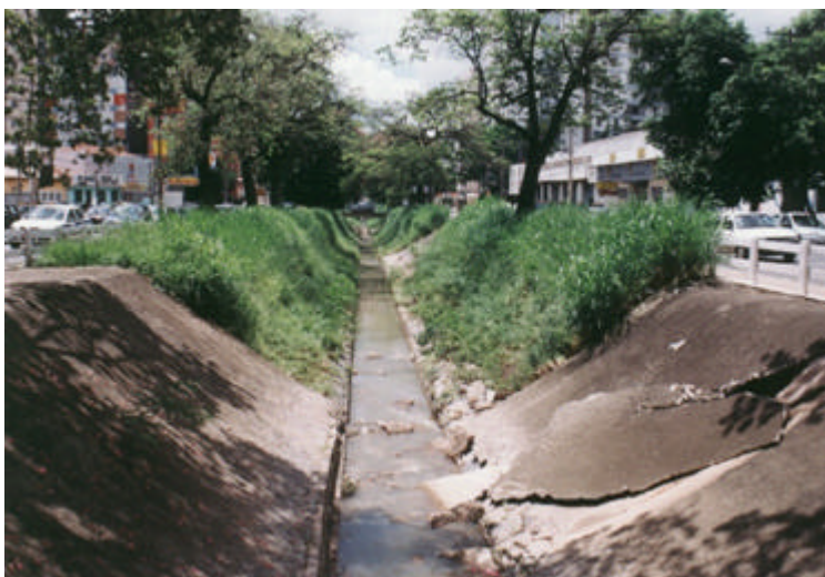
Foto 3. Desmoronamento da margem impermeabilizada do cor. Orosimbo Maia (enchente de 17/02/2003). Data 18/02/2003.
