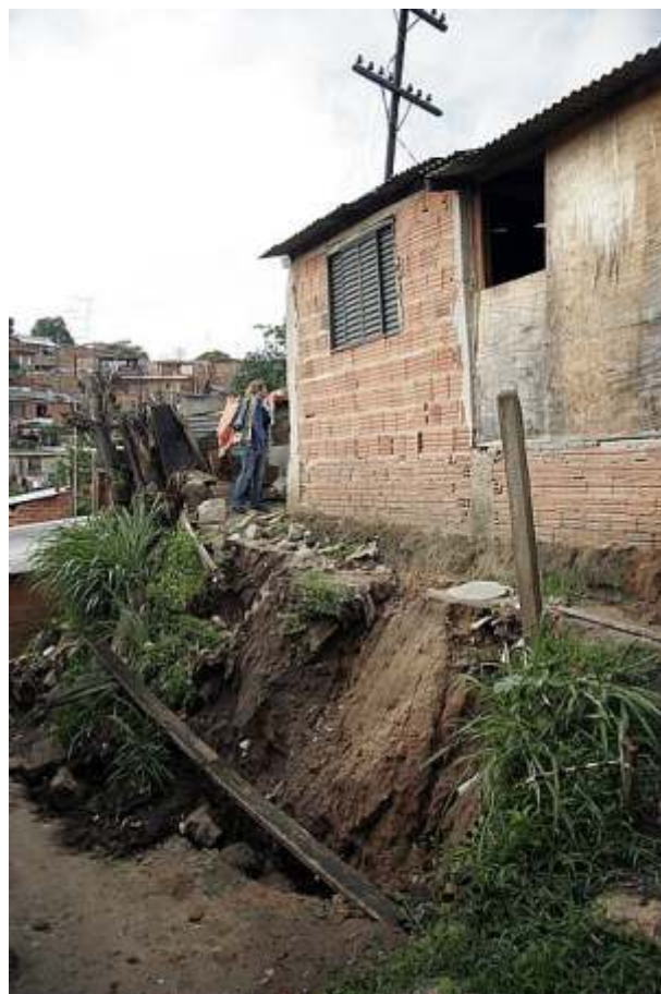
Favela São Fernando, risco: barranco que sustentava a casa, desaba após chuva - 26.11.2005
